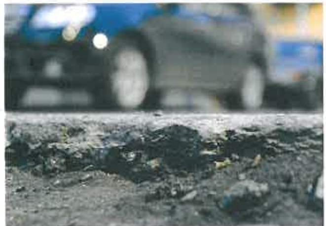
Abb. 1: Straßenschäden im Kreis Lippe
